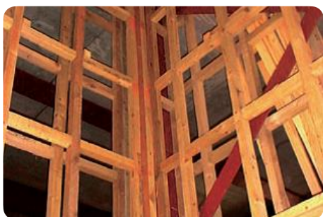
Gebruik van 350 m 3 gerecupereerd hout om de structuur voor gipsplaatwanden te maken, BedZED. © Bill Dunster Architects (ZEDfactory, 2002) (UK)
